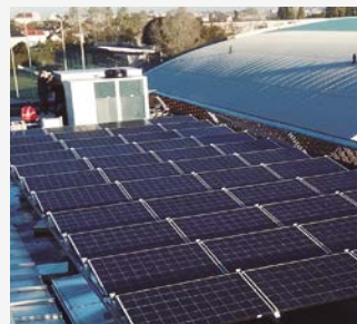
Amandiers Idrettsanlegg. Carrierre sur Seine, Frankrike. ECOi-W
